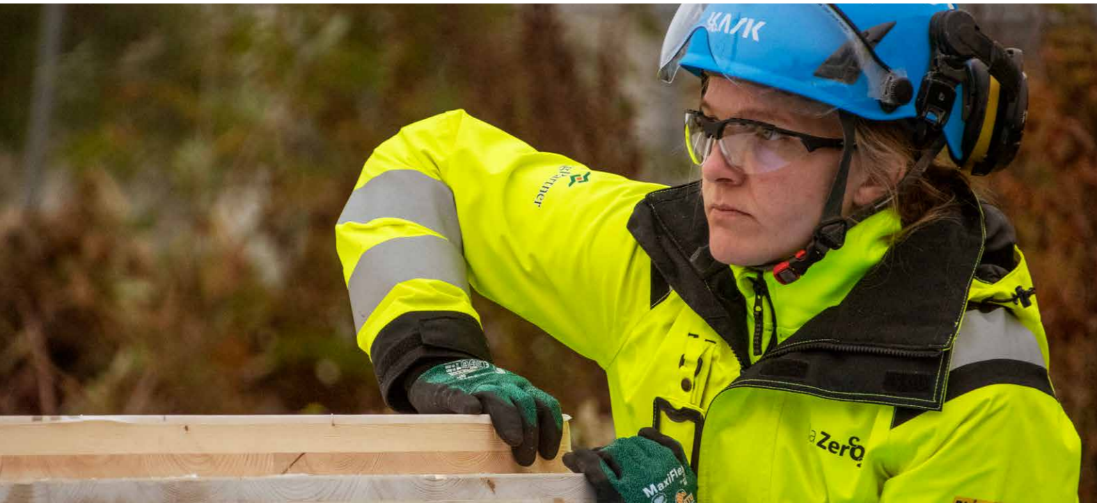
† Hantverkare Sofie Törnblom under stomresning av Villazero i Borlänge. Huset byggs helt i trä och certifieras enligt Svanden och NollCo 2 .
